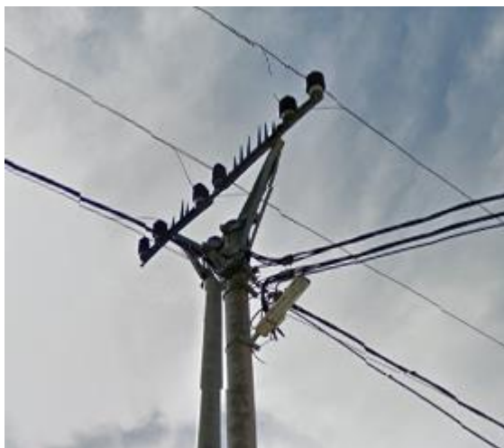
Obr. 6 Svetidlo umiestnené na podpernom bode VN vedenia
