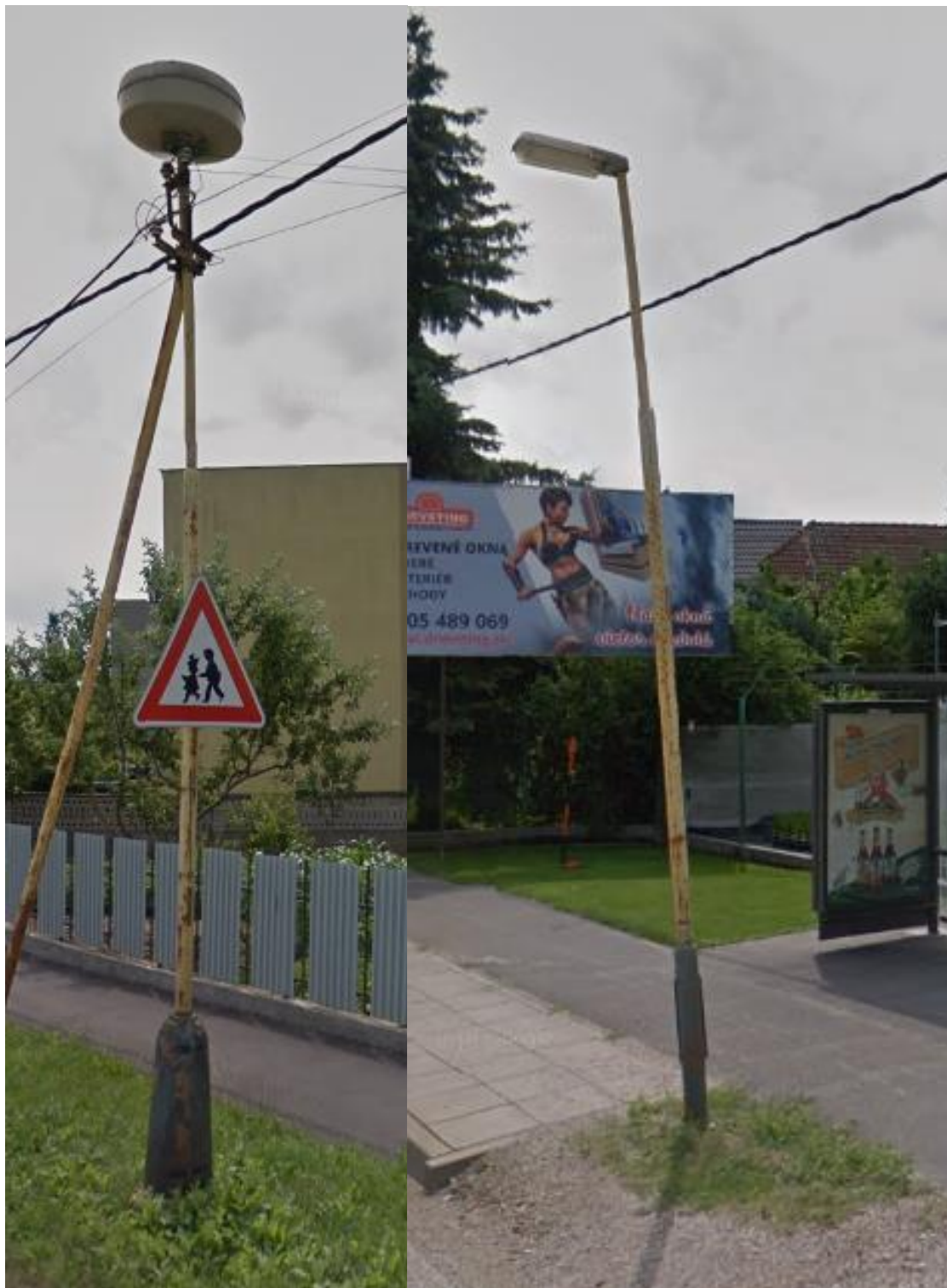
Obr. 4 Skorodovaný celový stožiar – potrebná rekonštrukcia
