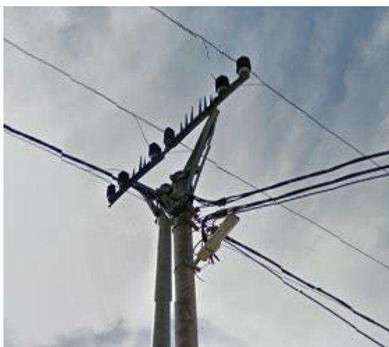
Obr. 6 Svetidlo umiestnené na podpernom bode VN vedenia
